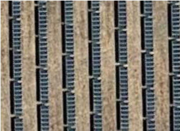
Detalle de paneles en central fotovoltaica
