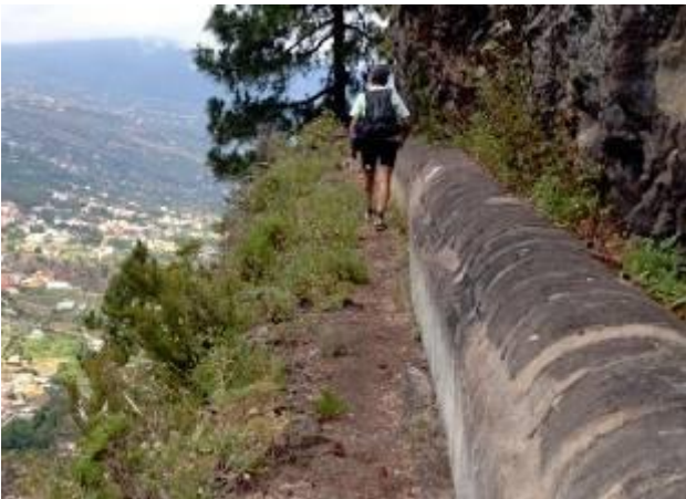
Tubería en superficie
