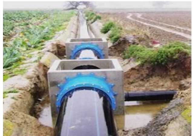
Tubería en superficie
